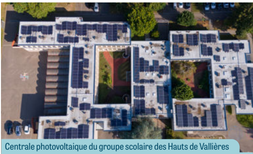
Centrale photovoltaïque du groupe scolaire des Hauts de Vallières
