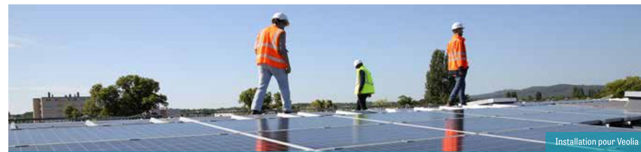
Panneaux photovoltaïques à Chambière
